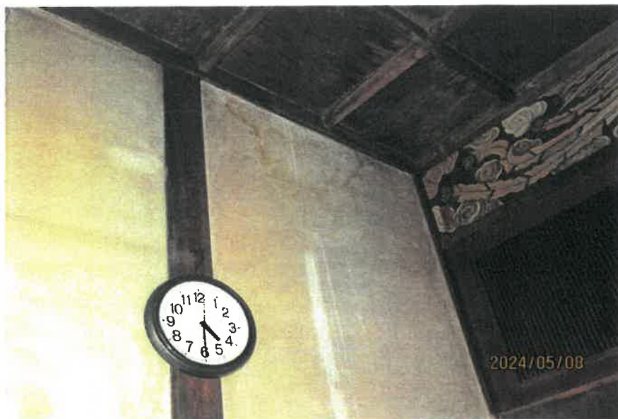
雨漏り跡の状況 染みの状況
