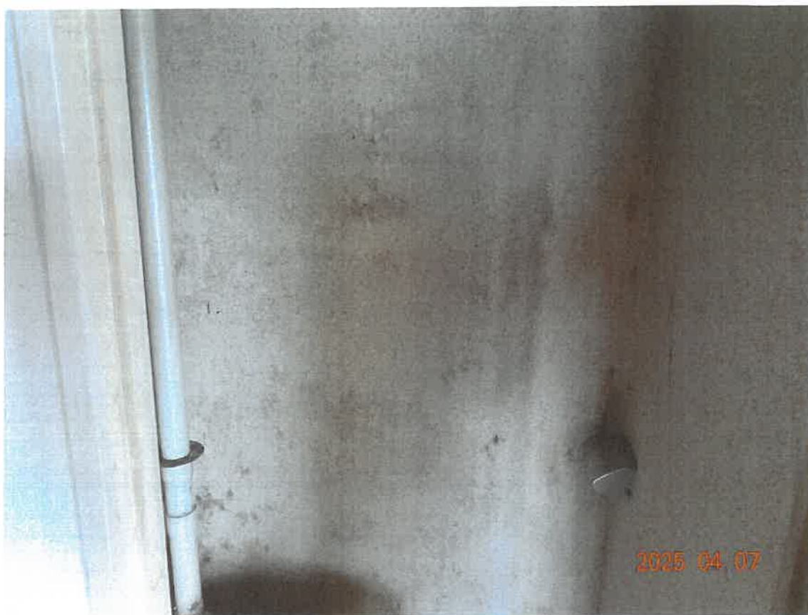
③トイレの壁の黒ずみ
