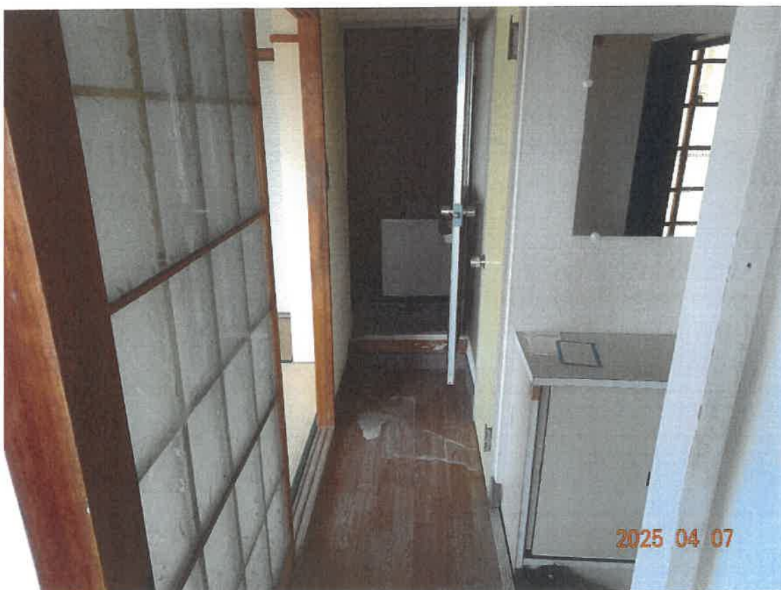
②廊下の床のしみ
