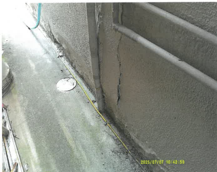
建物東側外壁のひび割れ
