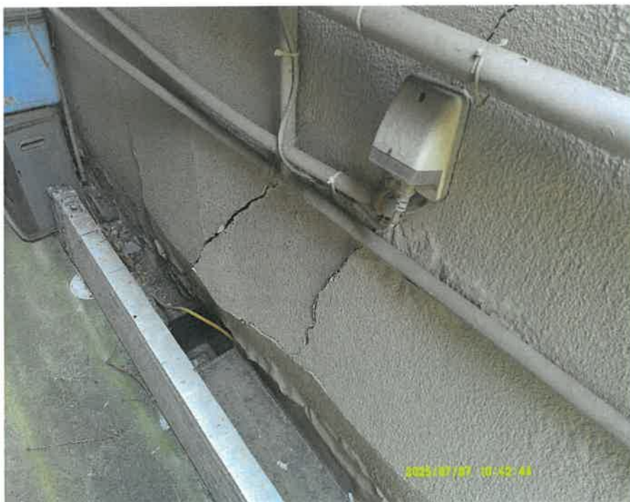
建物東側外壁の膨張部分
