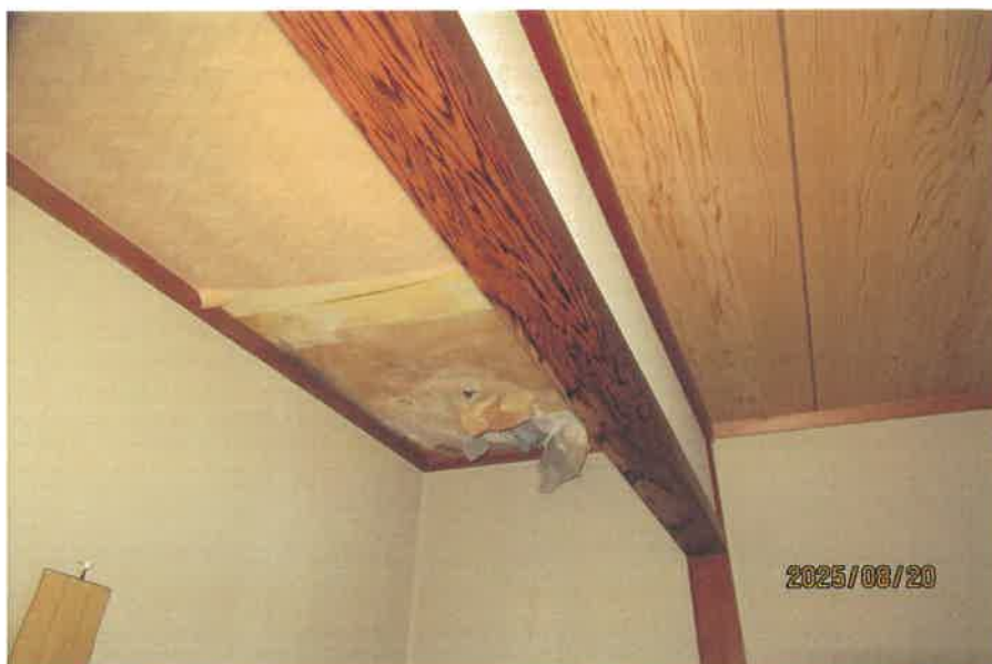
天井が破損している状況
