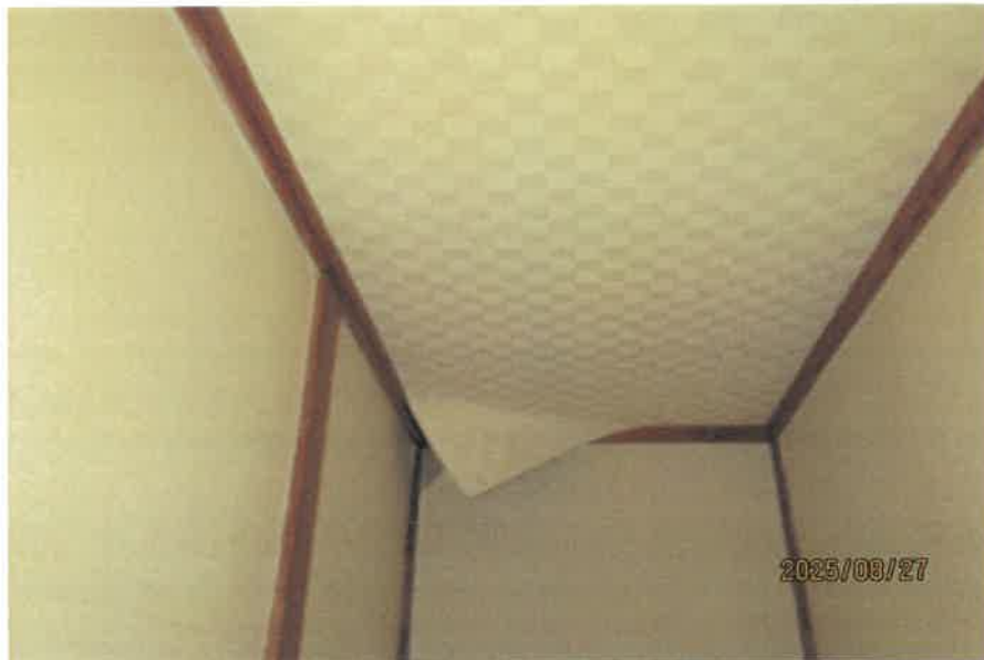
天井クロスが剥離している状況
