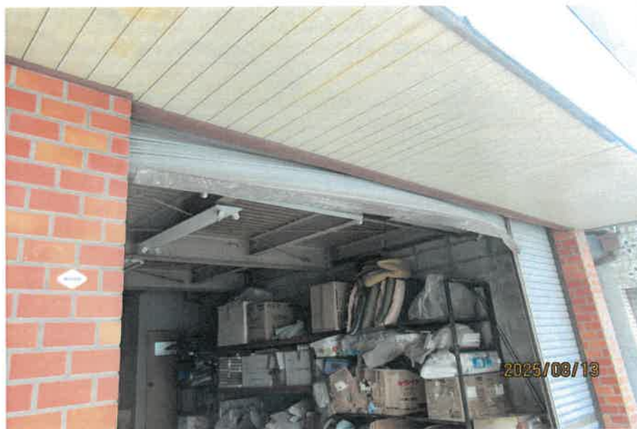
シャッターが破損している状況
