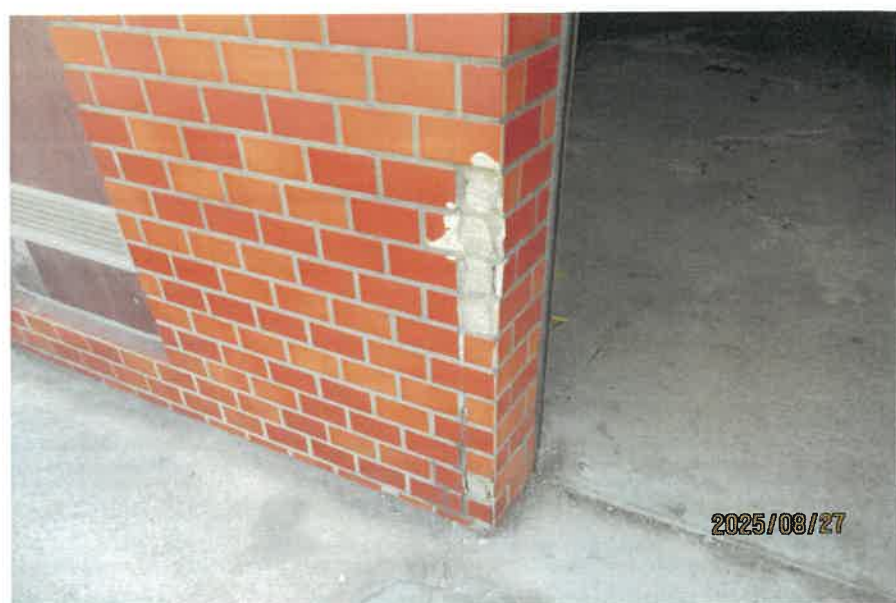
外壁が破損している状況
