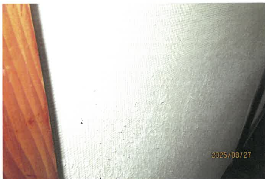
引っ掻き傷の状況
