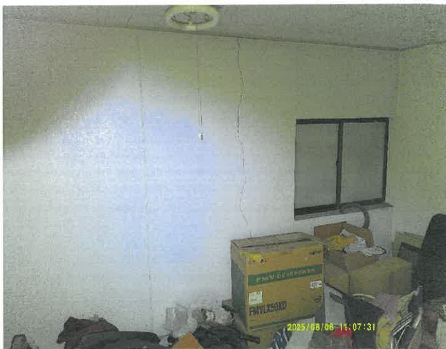
⑨ 1階車庫の西側壁のひび割れの状況
