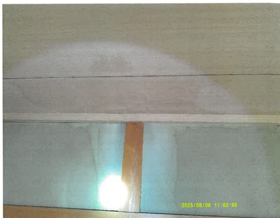
⑩ 3階北側和室の雨漏りと思われる染みの様子
