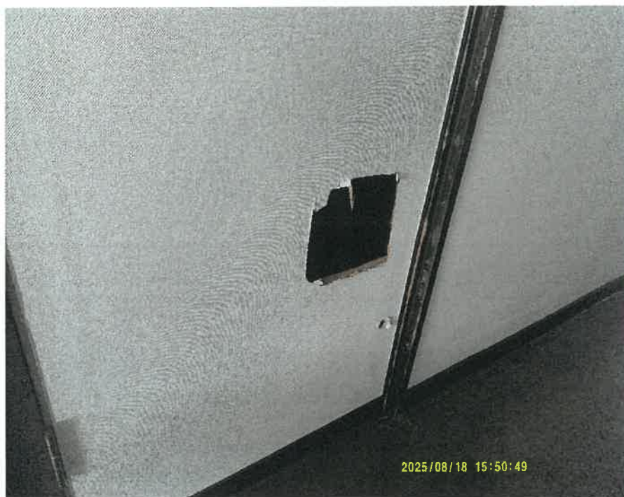
⑪ 1階トイレのドアの破損状況
