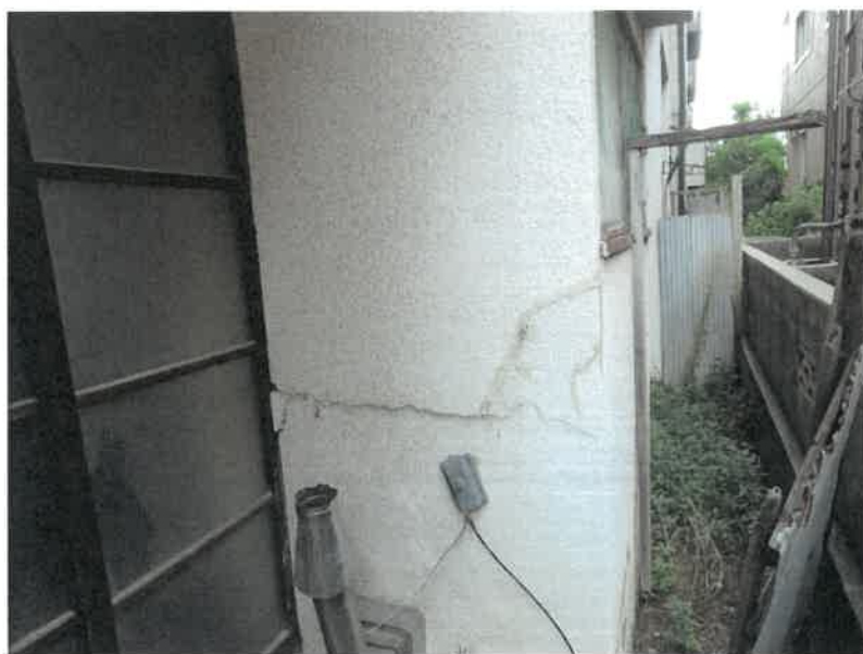
4 外壁のひび割れ
