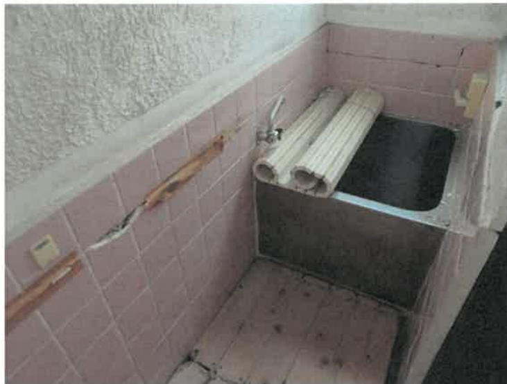
12 浴室のひび割れ
