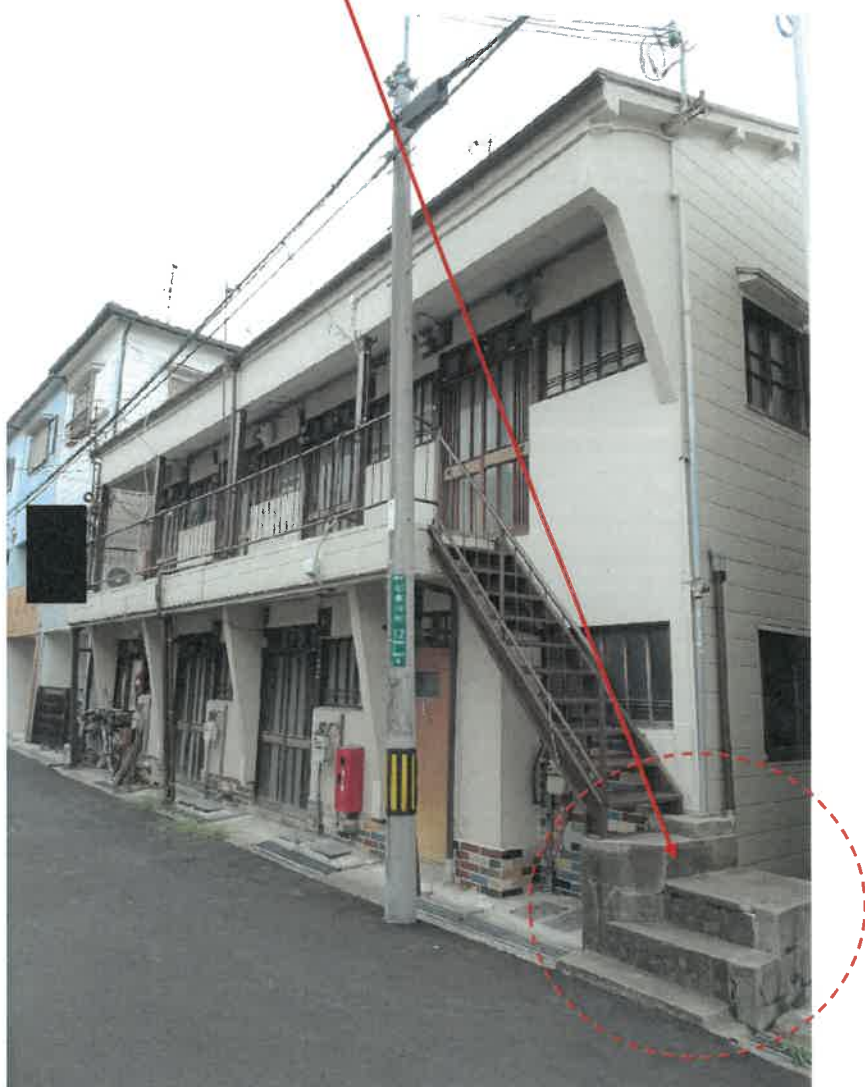
3 西側隣接地に越境可能性あり（階段）
