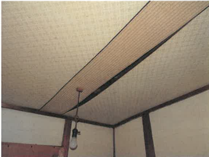
18 天井クロスの剥がれ
