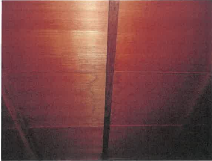
【2階西端】 17 天井の雨漏り跡
