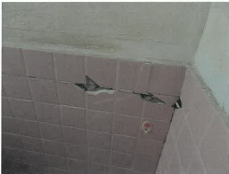
14 浴室のひび割れ
