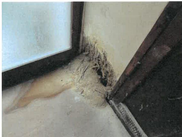
【1階西から3戸目】13 壁面の損傷
