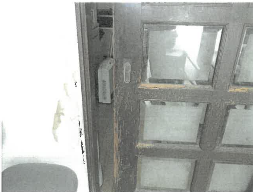
③ 壁の損傷
