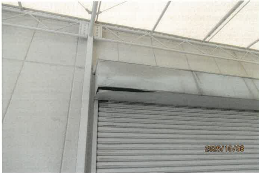
シャッター巻込部が破損している状況
