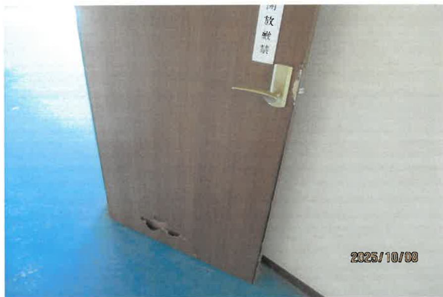
ドアが破損している状況
