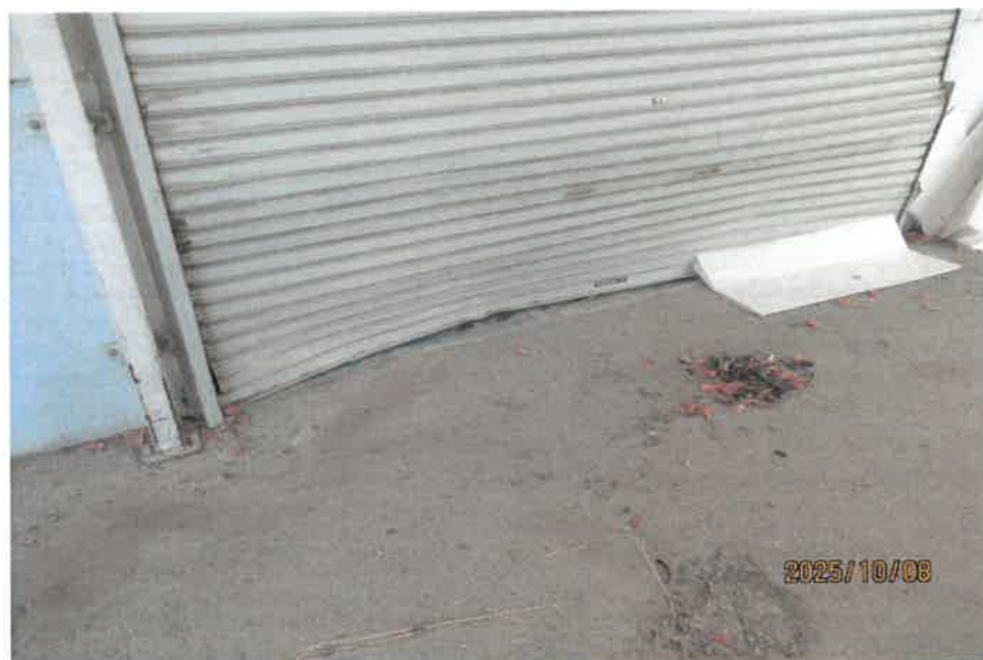
シャッターが破損している状況
