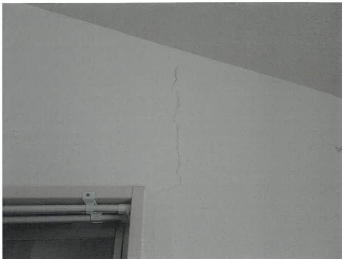
12 壁面クロスのひび割れ
