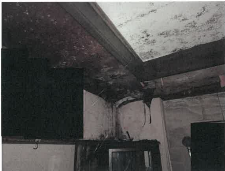
25 天井の損傷及び汚れ
