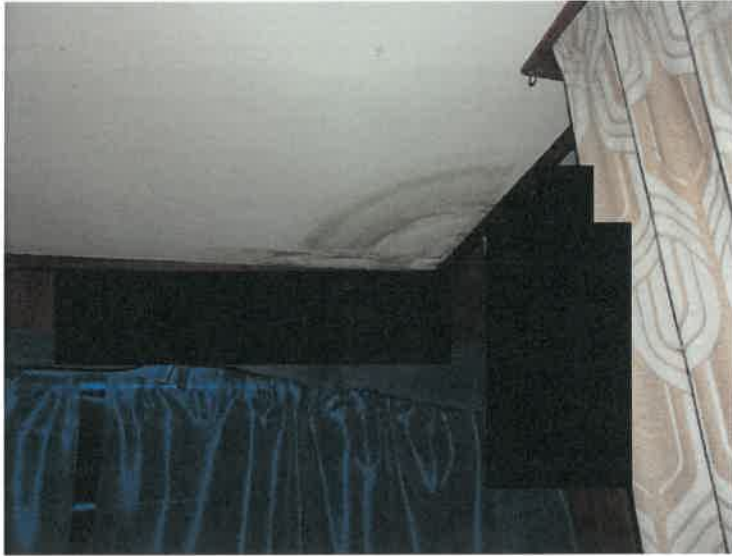
40 天井の雨漏り跡
