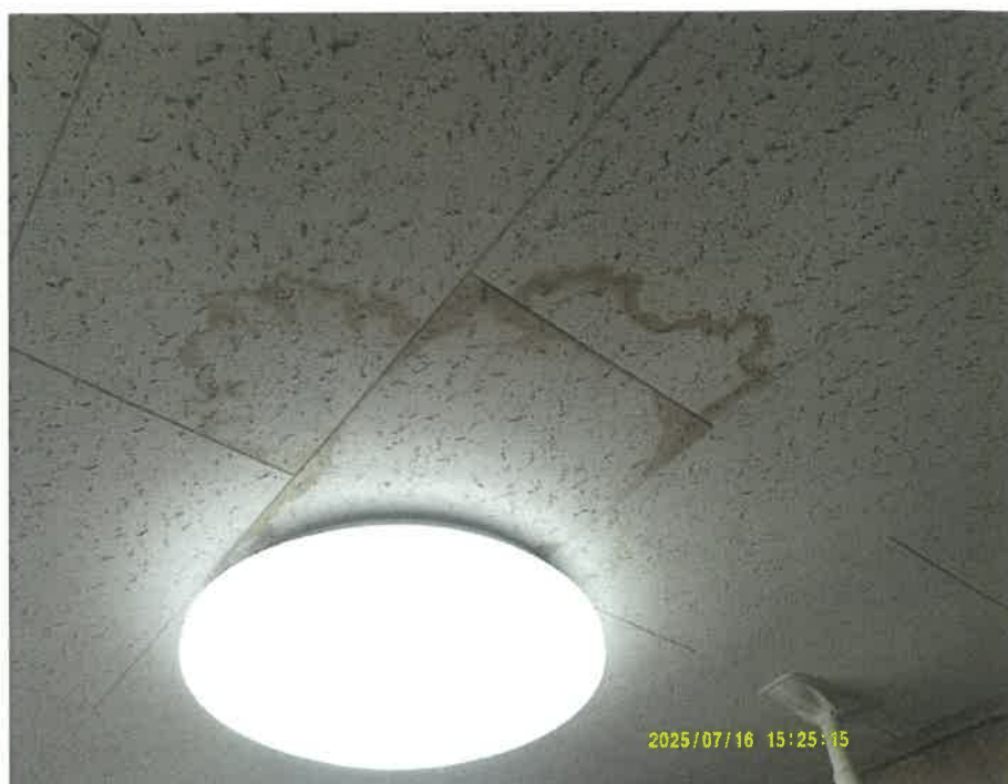
⑪ 2階天井の水染み
