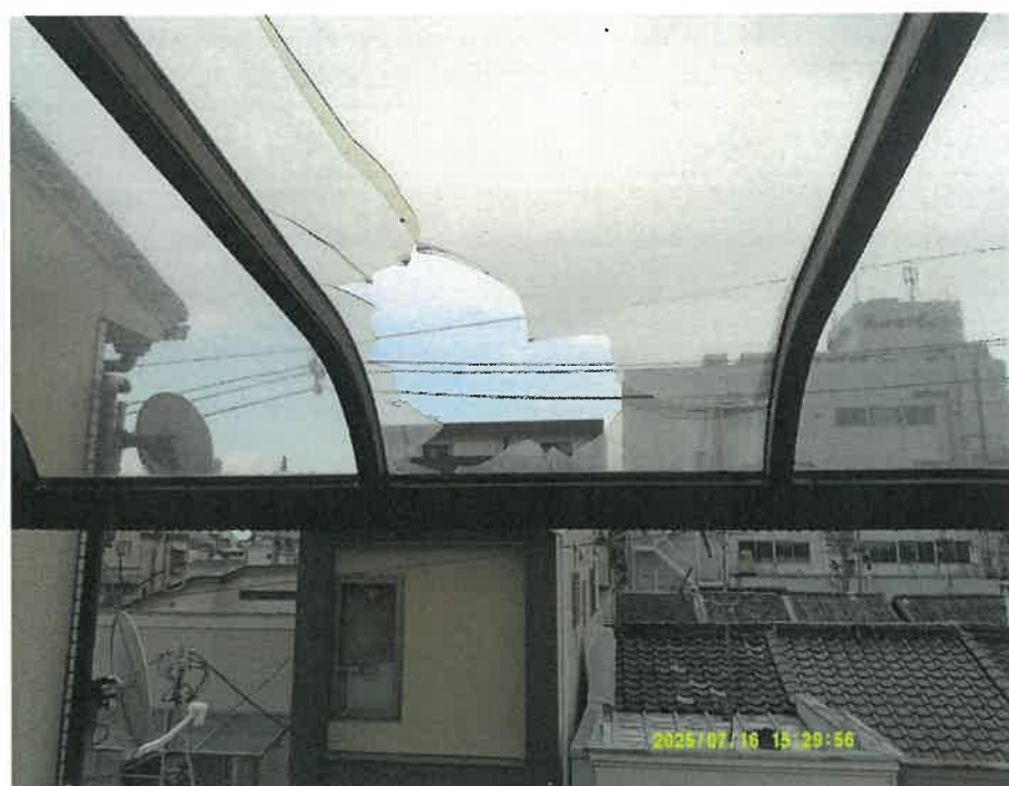
⑫ 3階ベランダの雨よけの破損箇所
