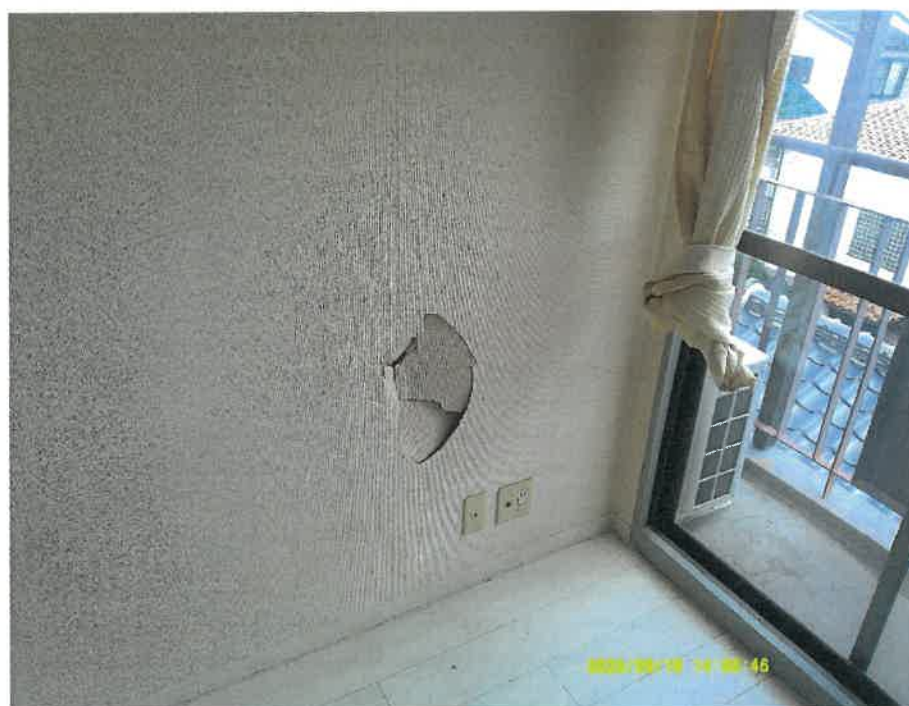
⑯ 403号室東側内壁の破損状況
