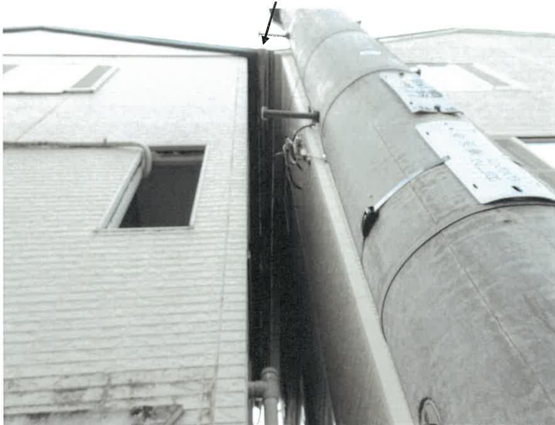
3 西側の雨樋が隣家と接着
