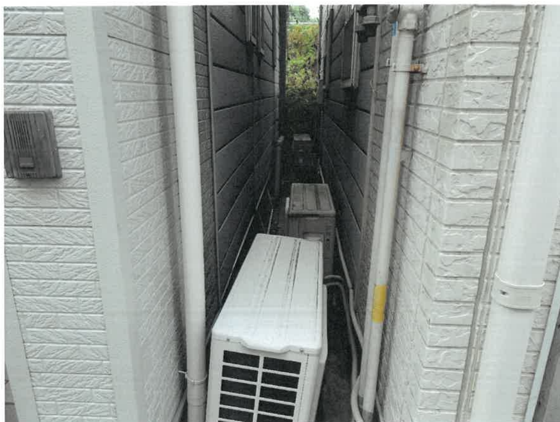
4 室外機（越境の可能性あり）
