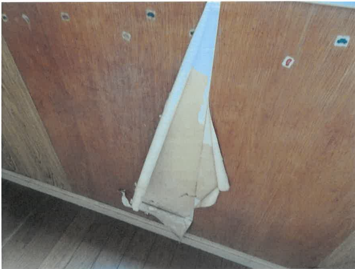
11 壁面の剥がれ
