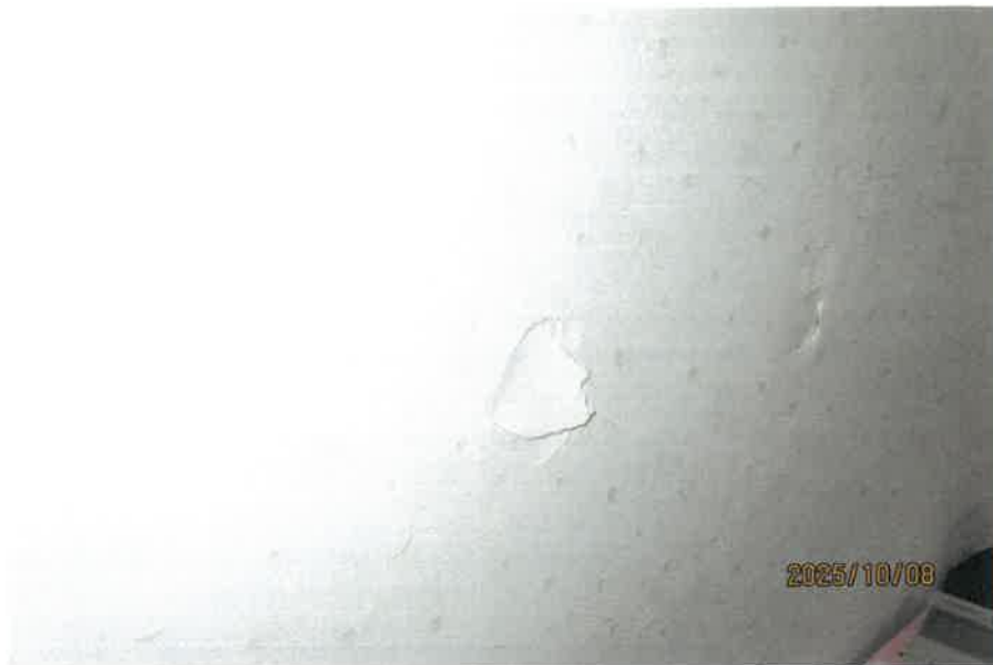
壁に穴が開いている状況
