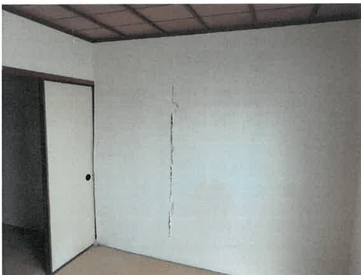
【401 号室】 24 壁面の亀裂
