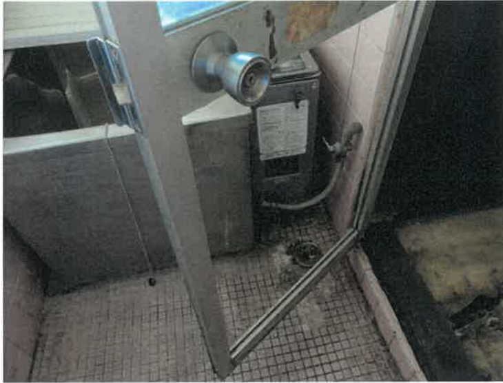
21 浴室扉の損傷
