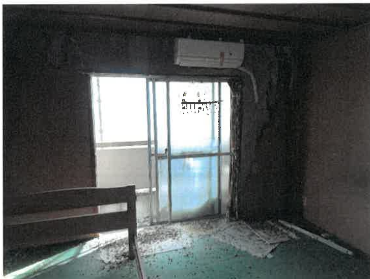
29 鳩のフン等による汚損
