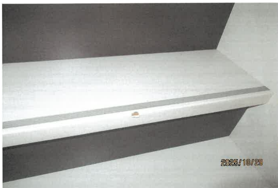
階段が破損している状況
