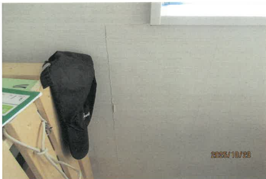
壁にクラックが入っている状況
