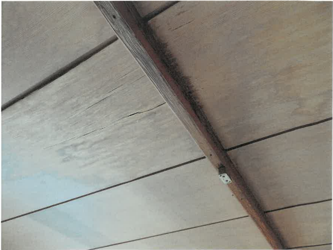
10 天井の雨漏り跡
