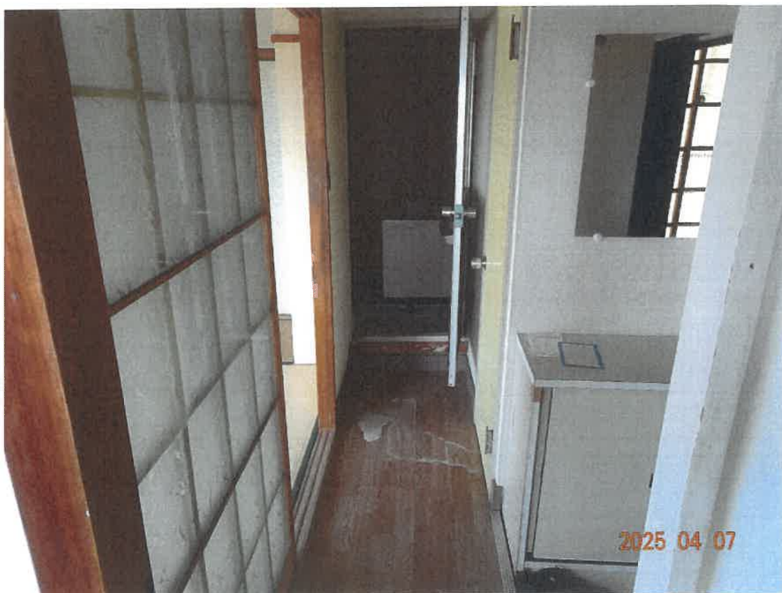
② 廊下の床のしみ
