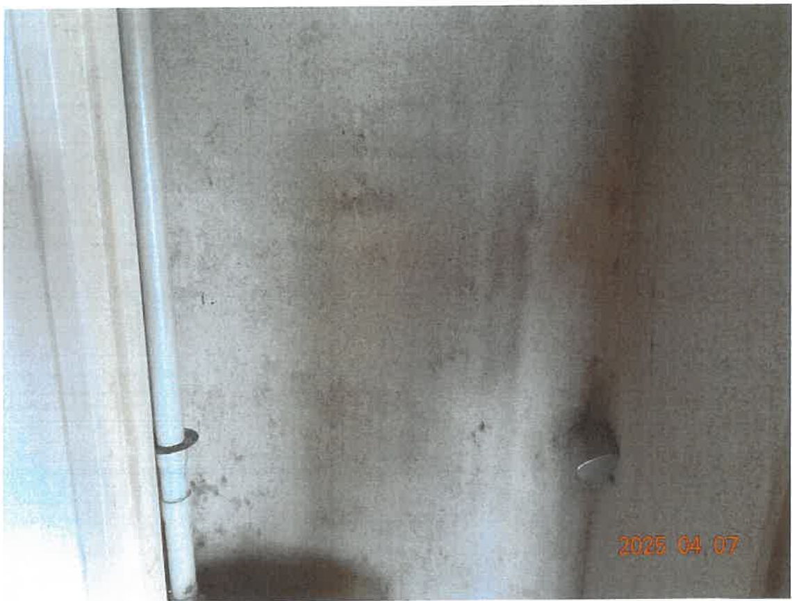
③トイレの壁の黒ずみ
