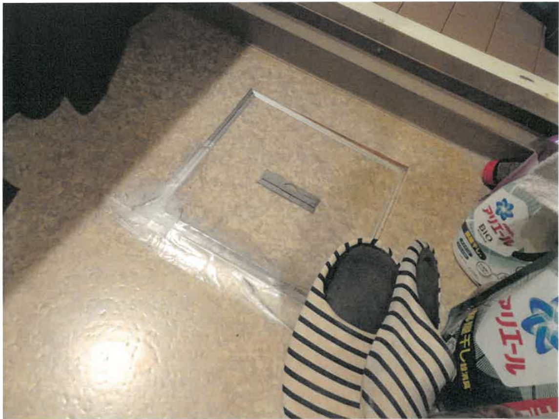
7 洗面室の床部分（踏むと床が抜ける可能性あり）
