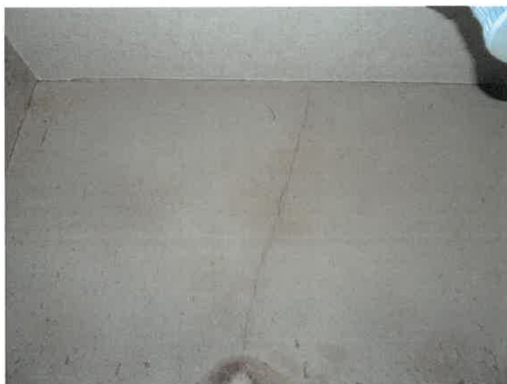
21 壁のひび割れ
