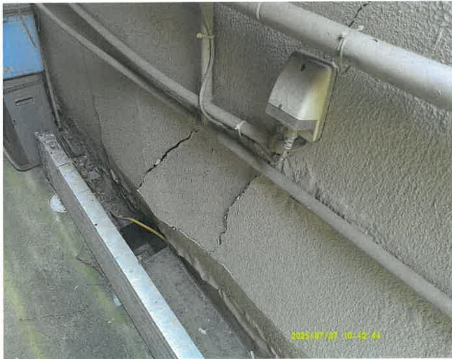
建物東側外壁の膨張部分
