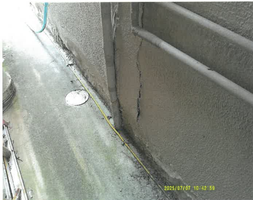
建物東側外壁のひび割れ
