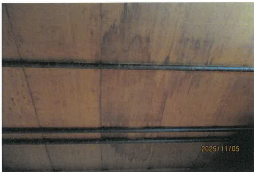
雨漏り跡の状況
