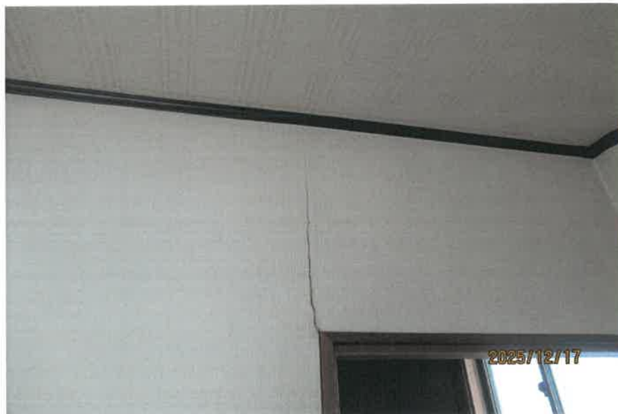
クラックが入っている状況
