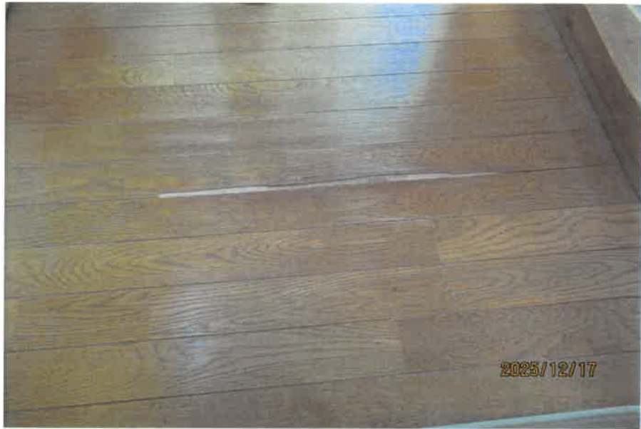
床が傷んでいる状況
