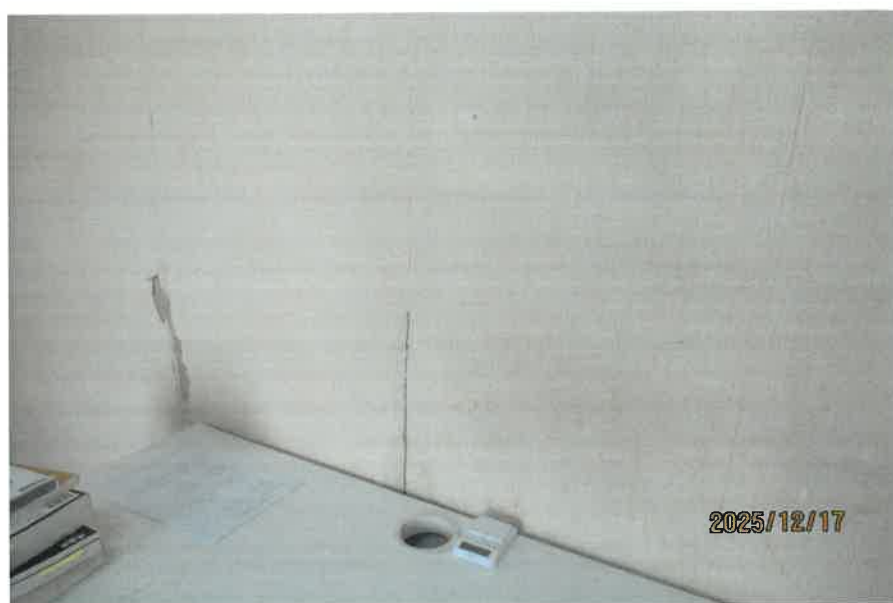
クラックが入っている状況
