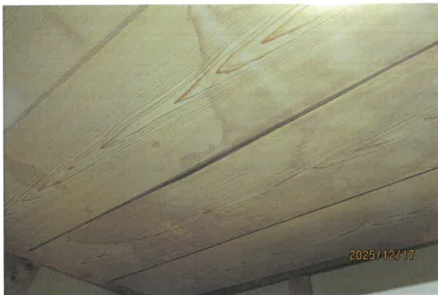
雨漏り跡の状況
