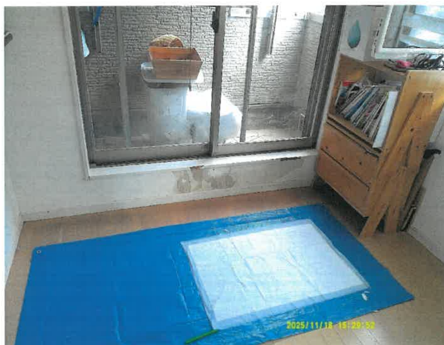
⑩ 2階LDK東側窓付近のクロスが剥がれ
