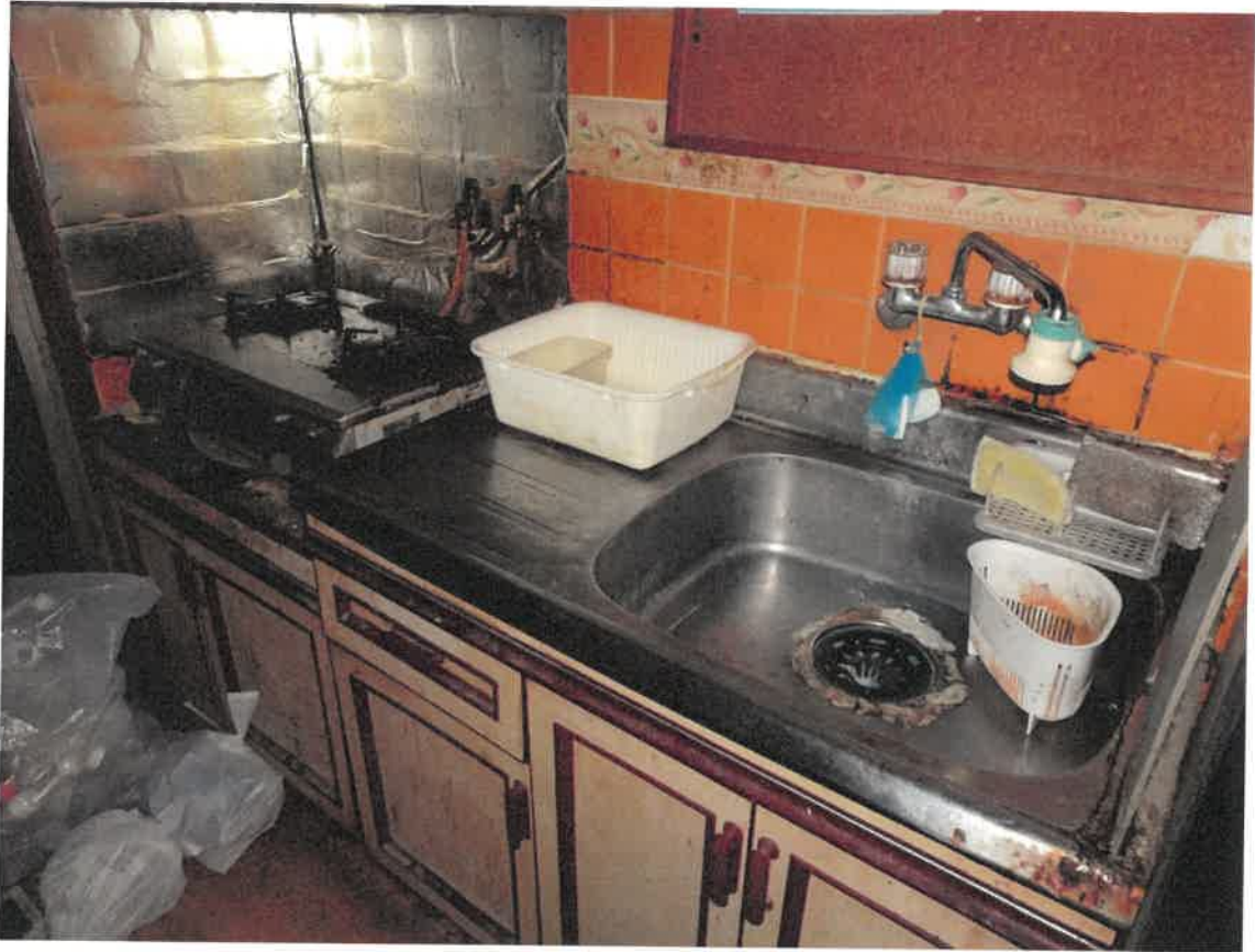
10 壁面のひび割れ
