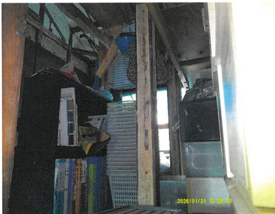
⑥ 2階東側の壁の状況
