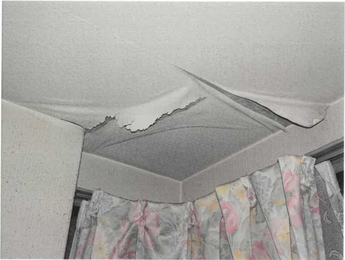
8 天井クロスの破れ
