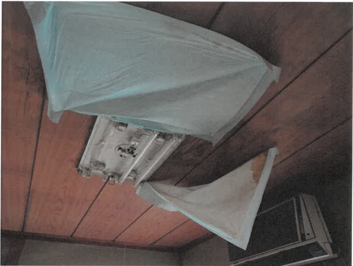
11 天井のシミ（雨漏り跡）
