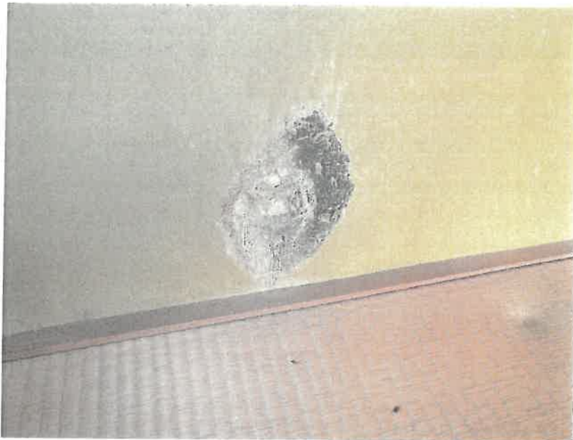
④ 壁の損傷
