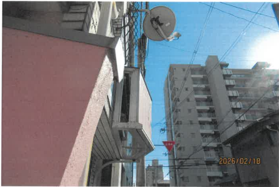
看板・衛星アンテナがはみ出している状況
