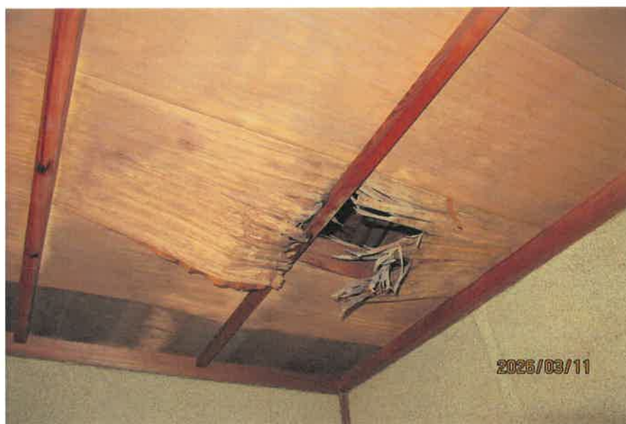
天井が崩落している状況
