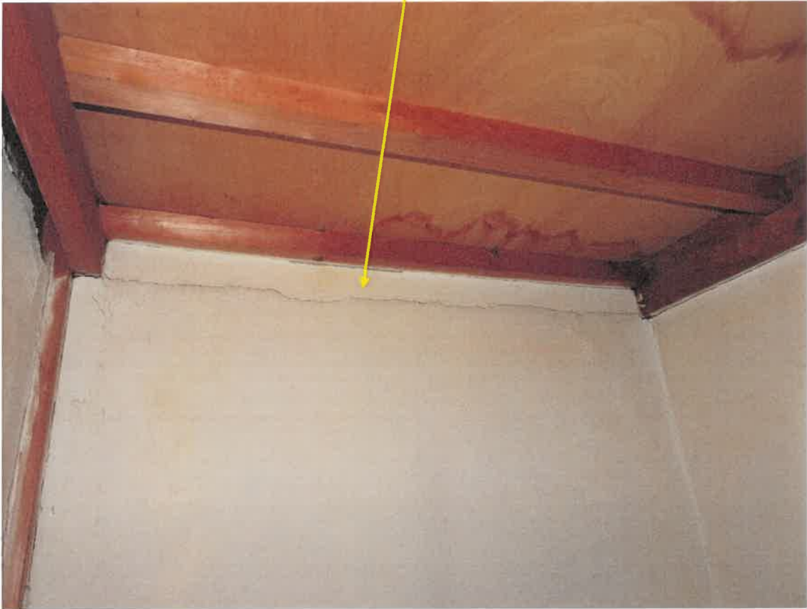
11 押入れ内の壁のひび割れ
