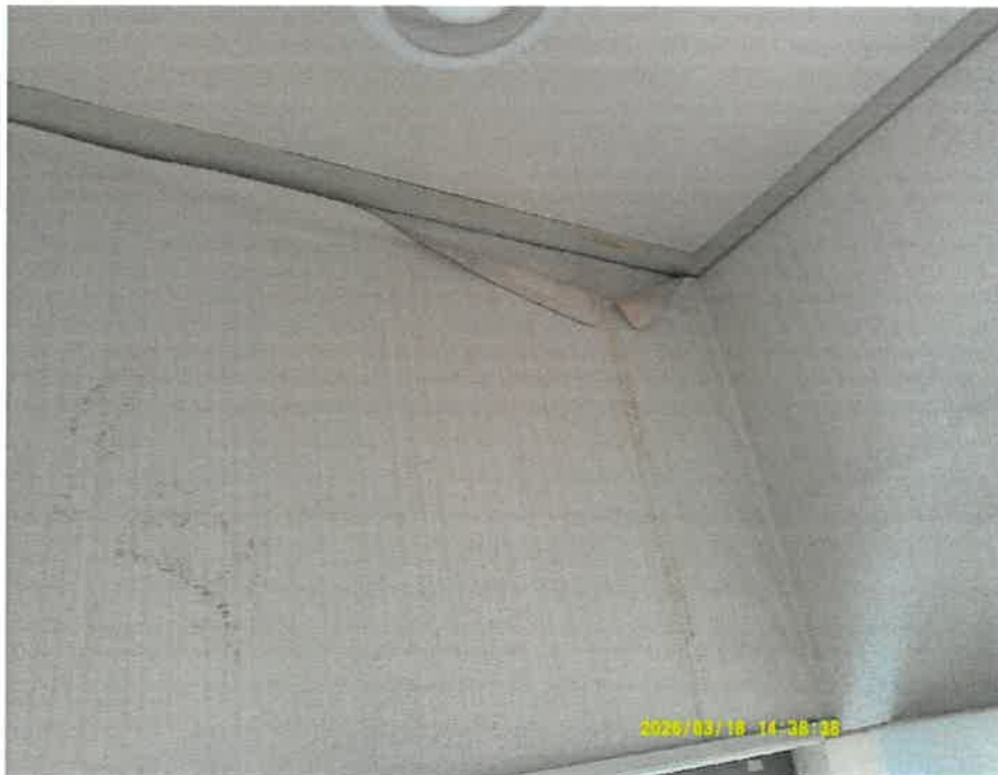
⑫ 内壁クロスの剥がれの状況
