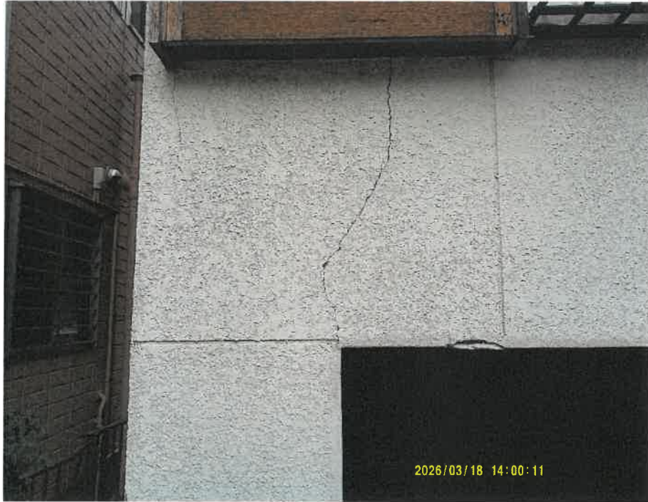
⑪ 外壁のひび割れの状況
