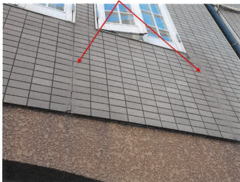
2 外壁の補修跡
