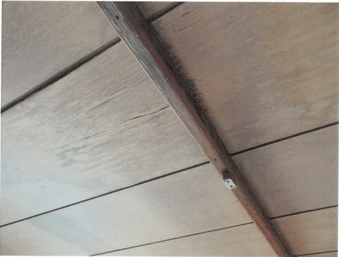
10 天井の雨漏り跡
