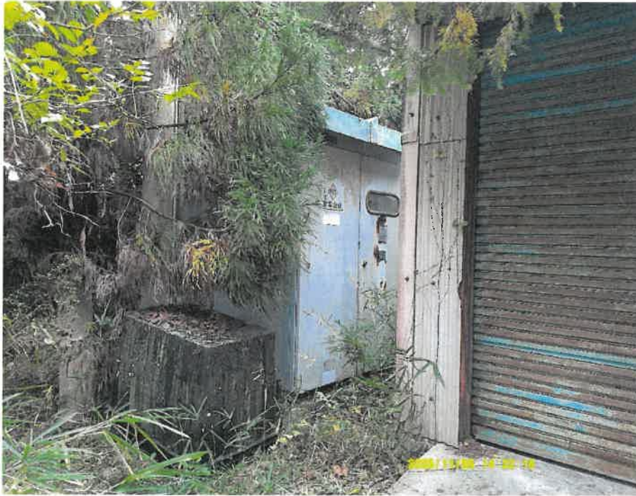
⑳ 物件 6 の南東側に存在する変電設備の状況
