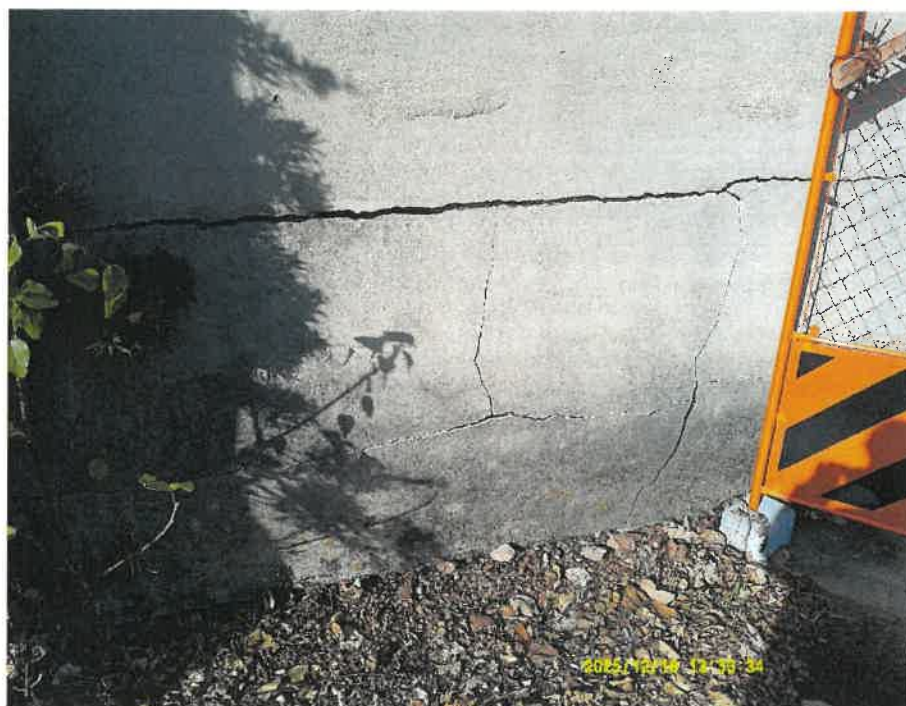
②⑥ 物件 9 の外壁のひび割れ
