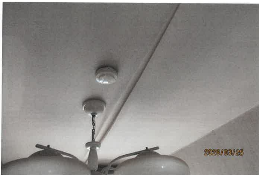
天井クロスが剥離している状況
