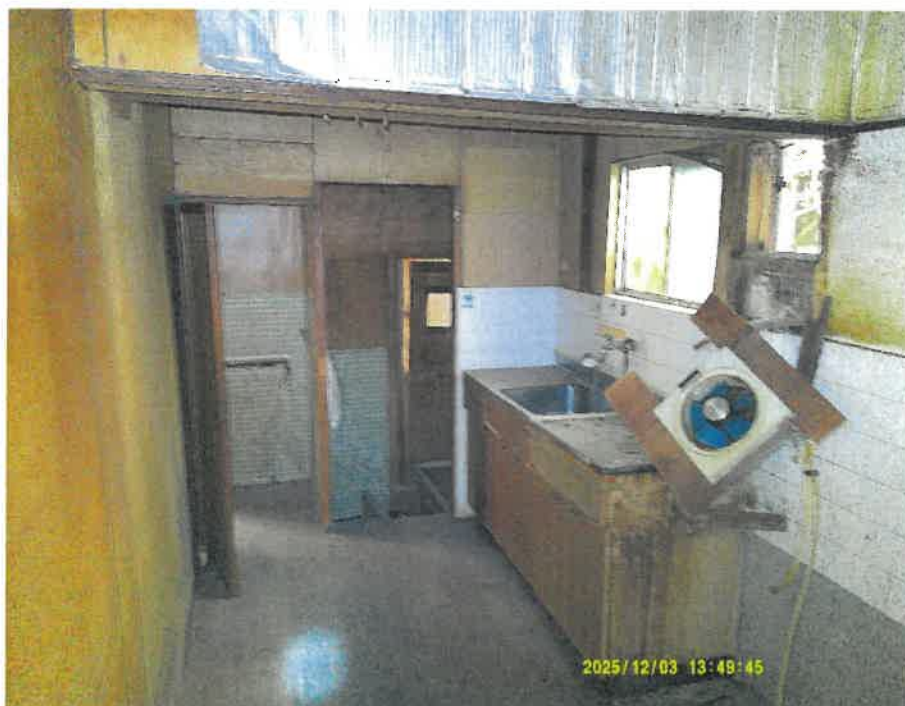
⑦ 換気扇部分が崩落している状況
