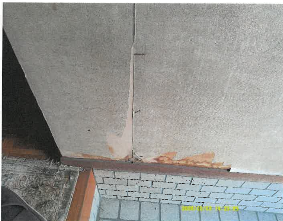
⑪ 1階玄関付近の壁紙の剥がれ
