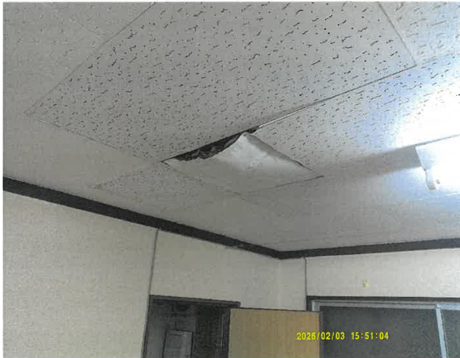
⑨ 2階北側事務室天井の破損状況
