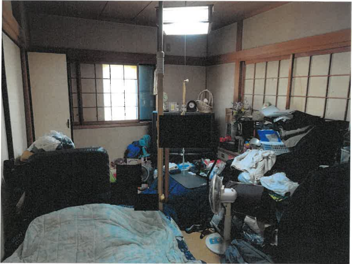
9 壁面のひび割れ
