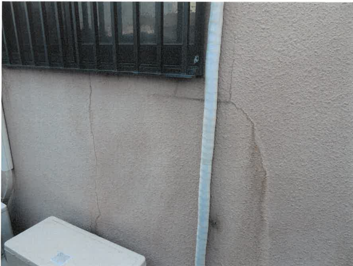
14 外壁のひび割れ
