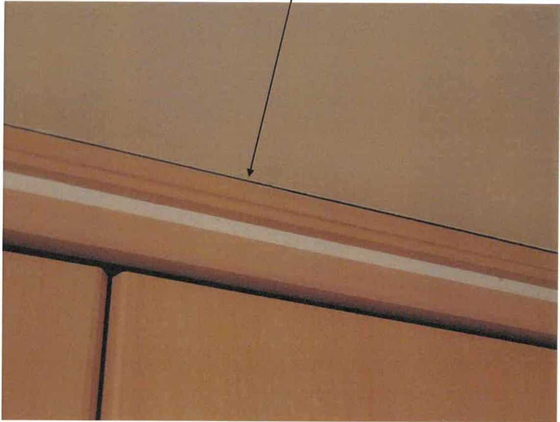
14 天井と壁に隙間
