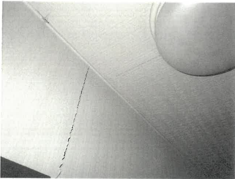
⑭ 壁と天井のひび割れ
