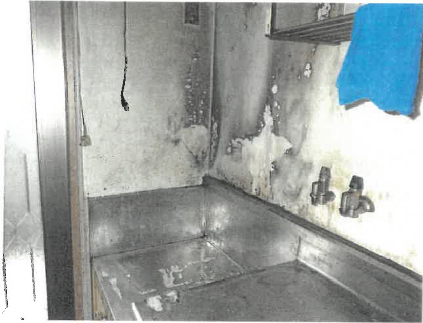
⑬ 壁の損傷
