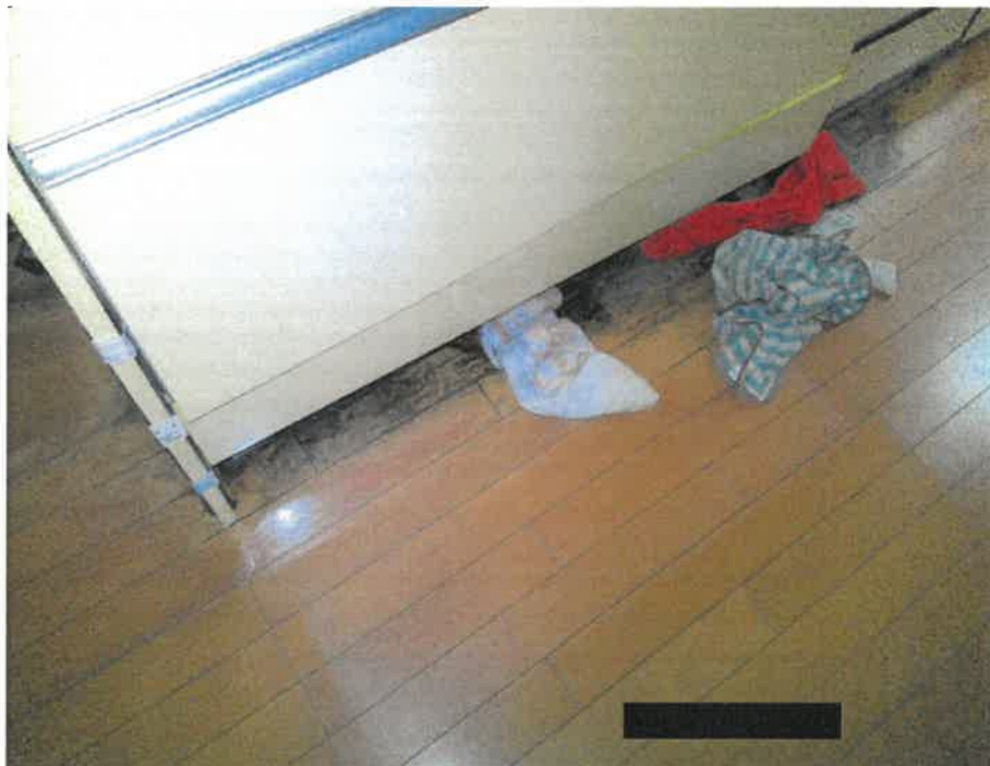
⑫ 流し台床面の破損状況
