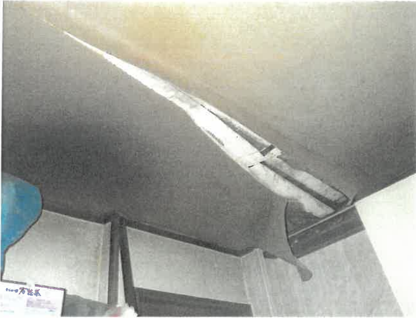
⑥ 天井の破損状況
