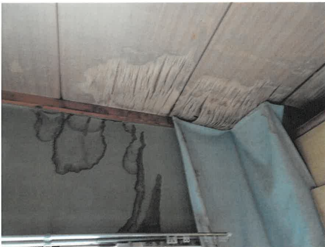
11 天井及び壁面のシミ
