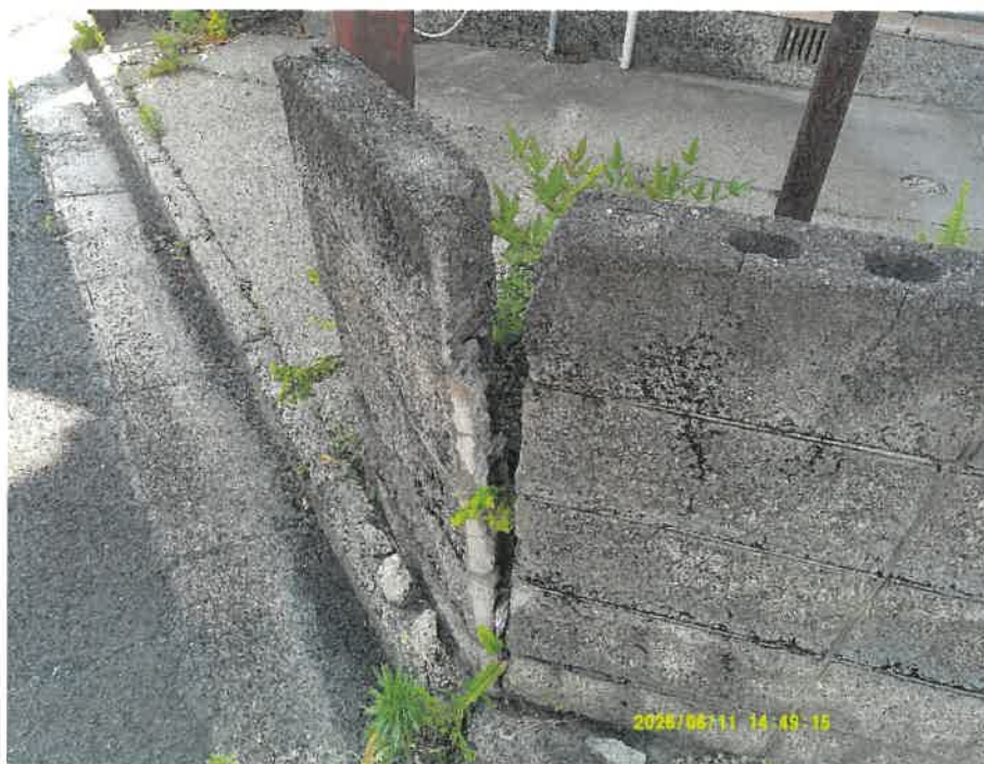
⑫ 南東側ブロック塀の破損状況
