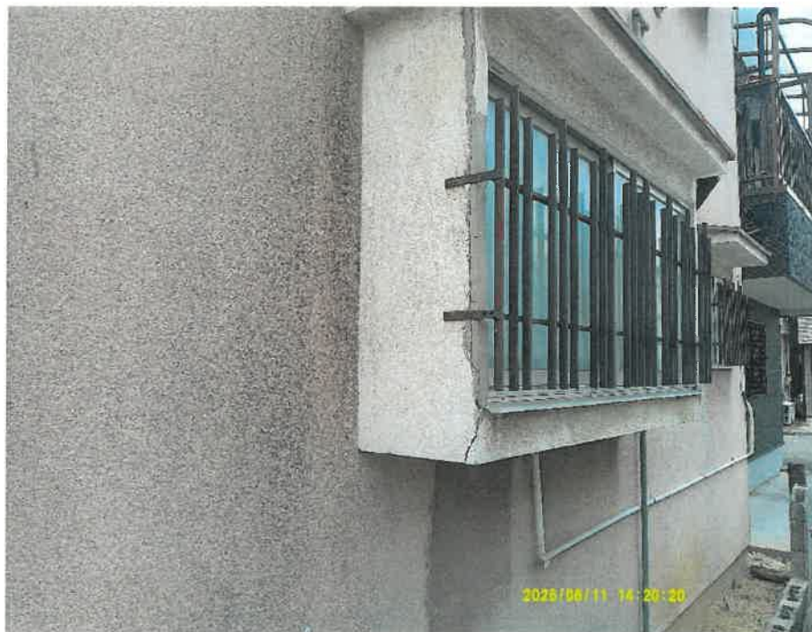
⑪ 外壁のひび割れの状況
