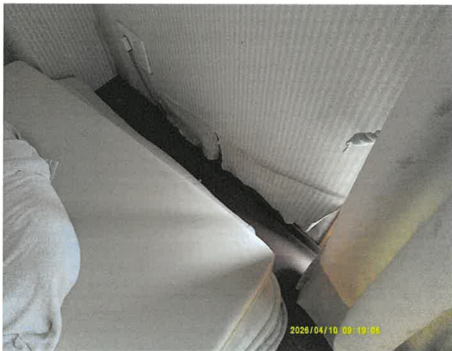
⑯ 3階北東側洋室の壁クロスの剥がれ
